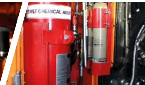
Système anti-incendie automatique
