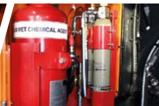
Système anti-incendie automatique
